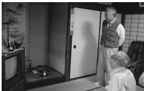
写真3 新たに発見した洪水の痕跡（楠戸武宅床の間）
