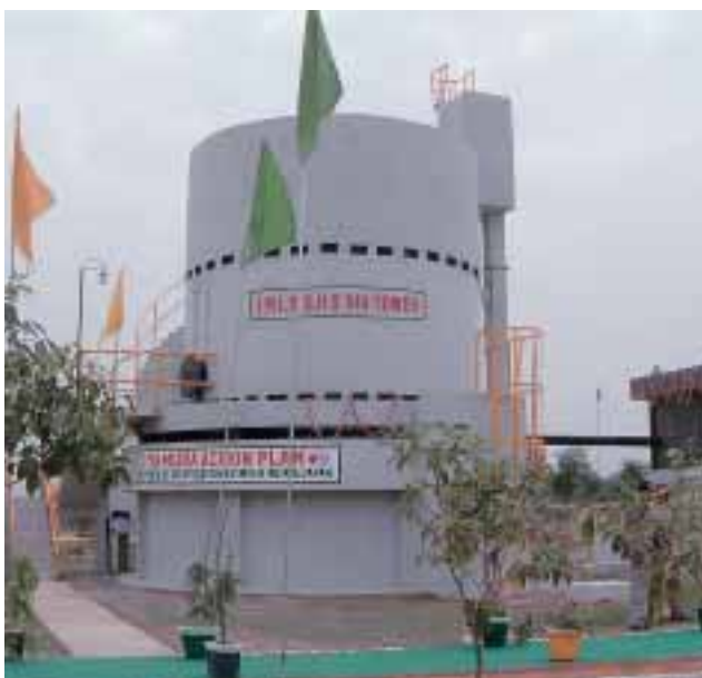
インド、カルナール市の下水処理場に設置されたDHSリアクター実証プラント (処理水日量1000トン、処理人口7000人規模)
