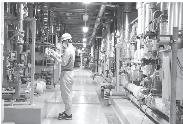
写真3 排水処理設備
