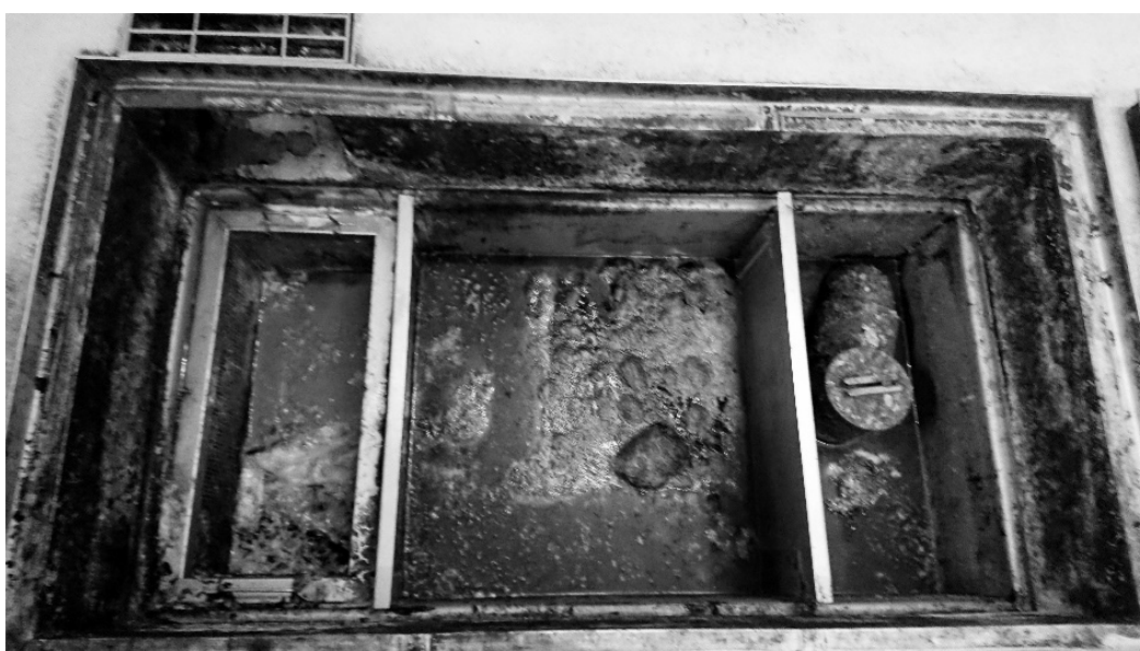
図1 大学生協食堂の排水溝内部
