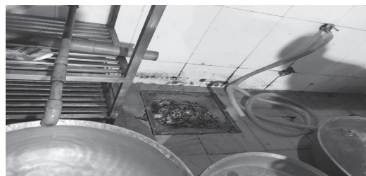
図7 プノンペン市内の厨房排水溝の様子
