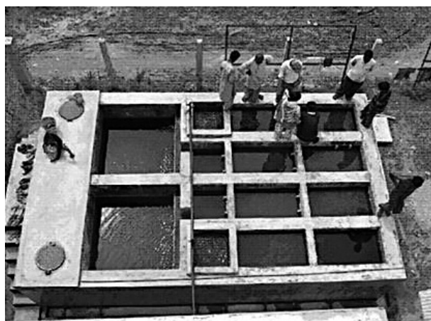
図18 上向き粗ろ過を4回繰り返す浄化装置
