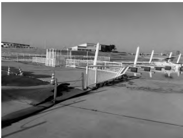
河川マリーナの震災被害（路面は波打ち、栈橋も倒壊）
