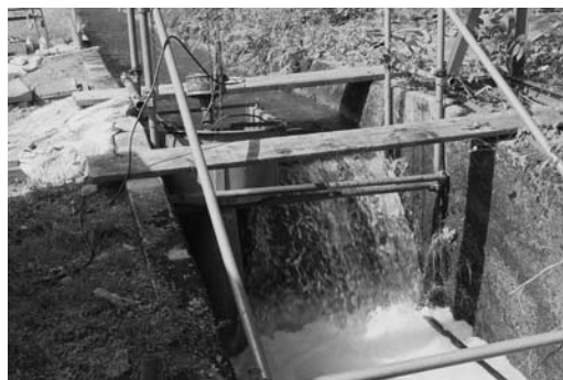
駒沢ミニ水力発電所
