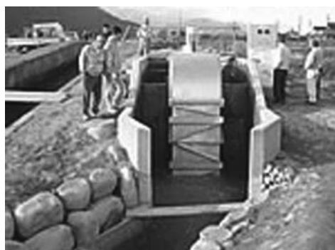
小西ミニ水力発電所
