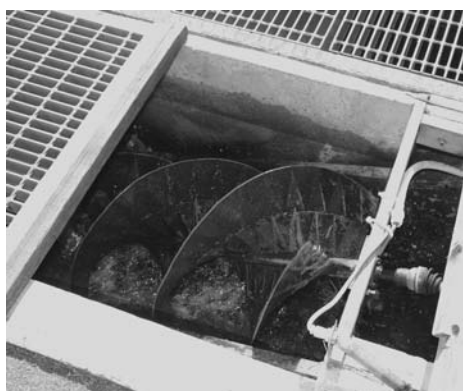
川上ミニ水力発電所
