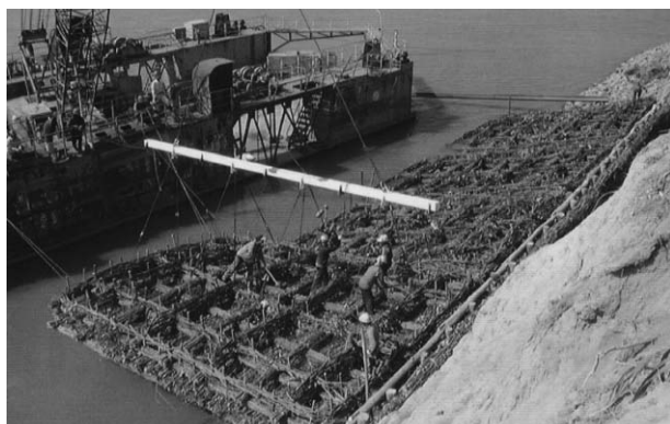
図6 台船上のクレーンによる粗朶沈床の設置 (国建協プロジェクト：2001)
