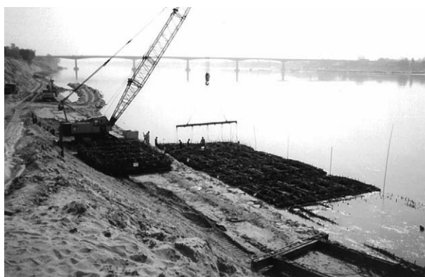
図7 陸上の大型クレーンによる粗朶沈床の設置 (JICAプロジェクト：2003)
