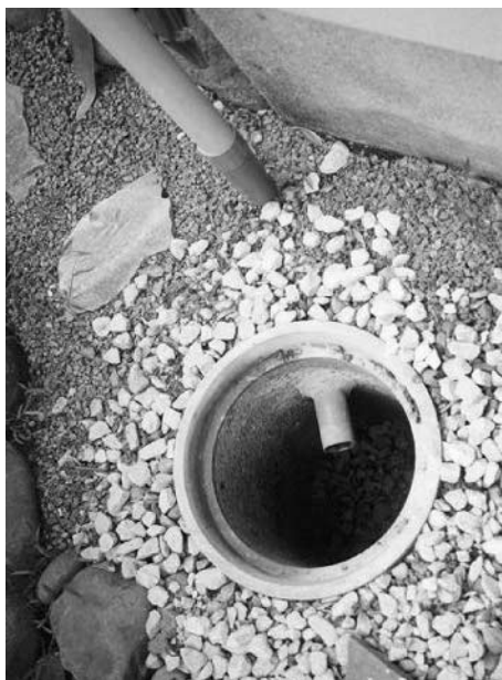
10 雨水浸透ます
