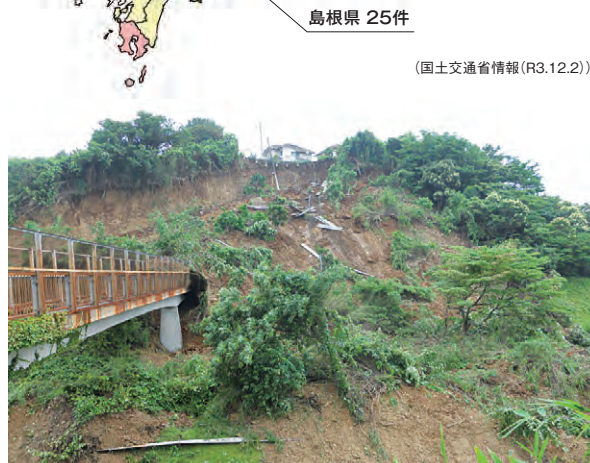
7/3 がけ崩れの状況 神奈川県逗子市沼間（国土交通省HP）
