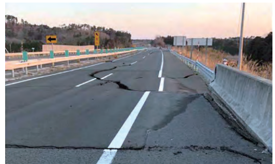
常磐道(上下線) 新地IC～山元ICの被害状況 （国土交通省東北地方整備局Twitter）
