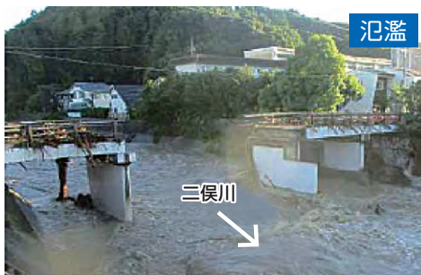
天竜川水系二俣川に架かる市道橋の一部損壊状況 静岡県浜松市 (国土交通省HP)
