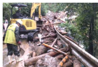
9/18 土砂崩等の状況 大分県臼杵市野津町 (国土交通省HP)
