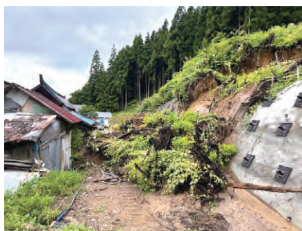
8/4 がけ崩れの状況 福島県喜多市熱塩加納町 (国土交通省HP)
