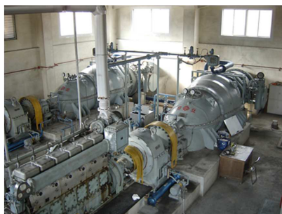
写真3 川島排水機場 ポンプ設備 (昭和39年)
