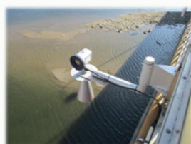
カメラ・水位計等による観測
