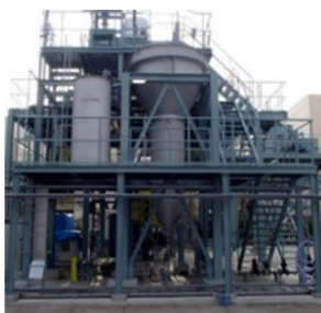
横浜市リン回収施設
