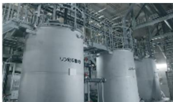
東京都リン回収施設
