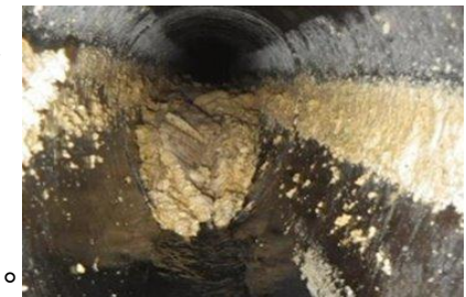
脂で閉塞した管路(出典:川崎市HP)
