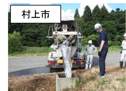
農業用水路への給水状況
