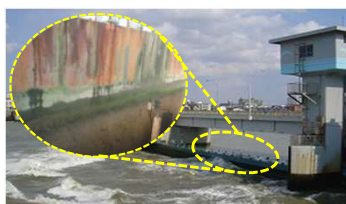
ゲート設備劣化(堰)
