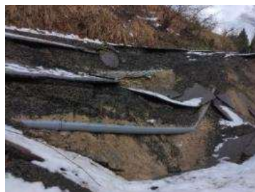
送水管の被害(輪島市)
