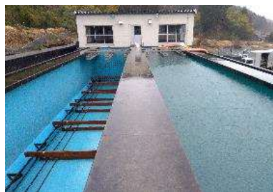
浄水場の被害(珠洲市宝立浄水場)
