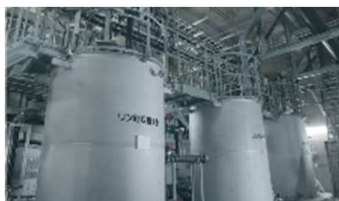
東京都リン回収施設
