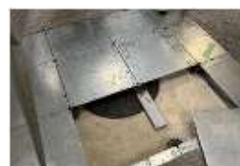
能登空港ビルにおける活用事例 (建物地下に設置された雨水貯留槽)
