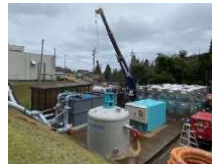
可搬式浄水施設・設備(珠州市宝立浄水場)
