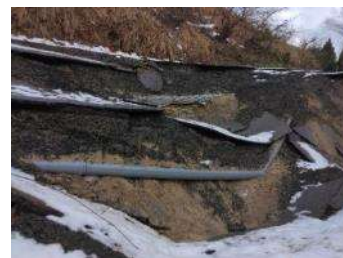
送水管の被害(輪島市)
