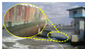
ゲート設備劣化(堰)
