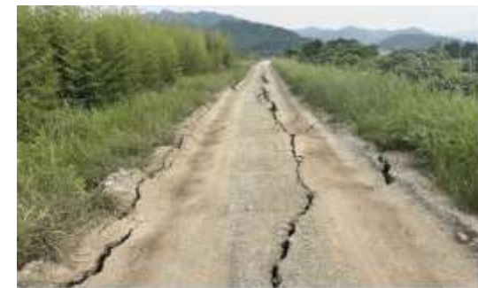
堤防天端の亀裂(広渡川水系広瀬川(宮崎県管理))
