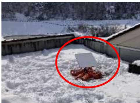
▲ 低軌道周回衛星を使用した衛星通信装置
