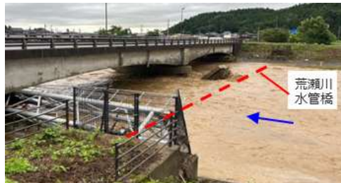
水道被災箇所(酒田市荒瀬川水管橋)
