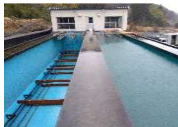
浄水場の被害(珠州市宝立浄水場)
