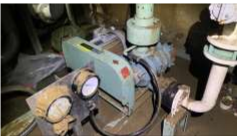
浸水した曝気ブロー
