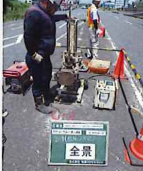
貫入試験による空洞調査
