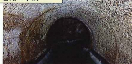
管の腐食から緊急度Ⅰと判定
