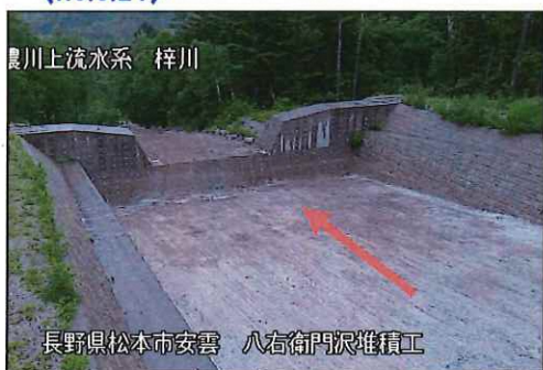
土砂流出発生前 (R6.6.21)
