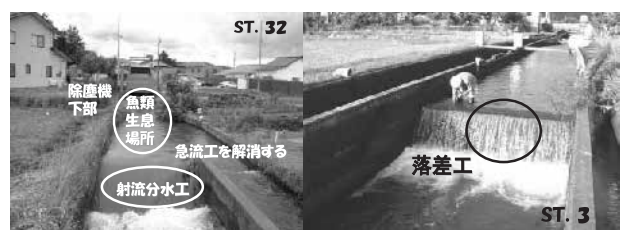
写真5 遡上障害となっている分土工や落差工
