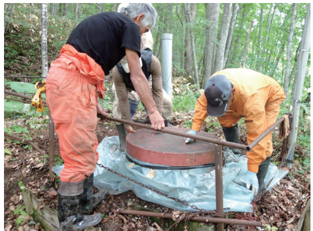
図3 地域で丁寧に管理されている水道施設
