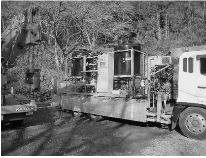
図4 可搬式浄水設備の運搬状況
