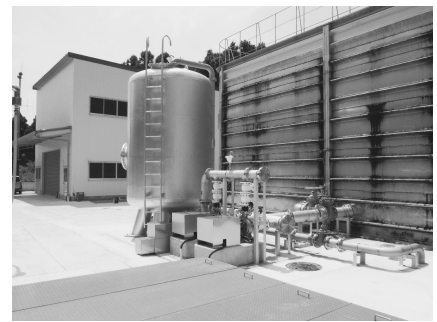
図12 災害の2年後に設置した本設のろ過設備
