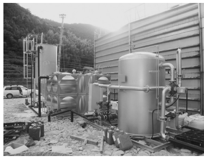
図11 被災後の瓦礫の中に設置した仮設のろ過設備
