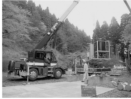
図5 可搬式浄水設備の設置状況
