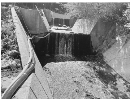
図22 取水地点から浄水場に布設した仮設配管
