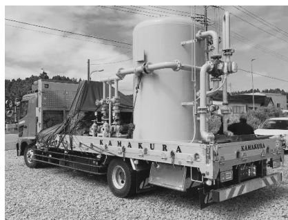
図23 被災地に移送される仮設ろ過設備
