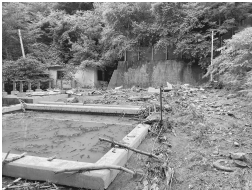
図21 土砂崩れにより壊滅状態となった浄水場内
