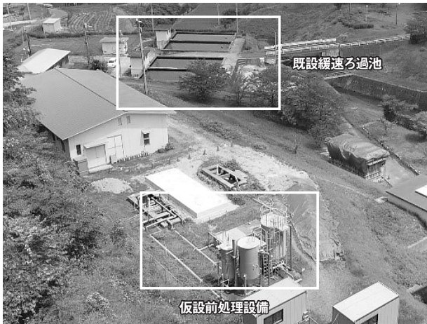
図19 仮設前処理設備設置後の浄水場
