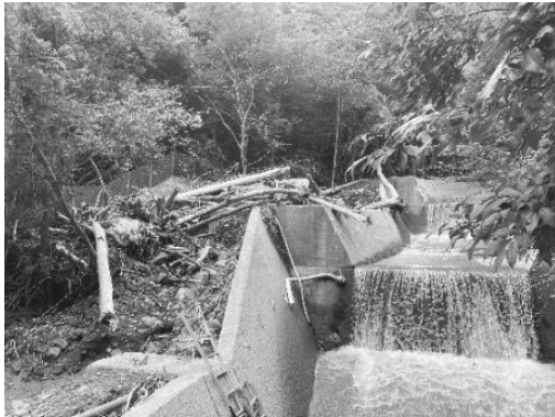
図20 土砂崩れにより被害を受けた取水地点
