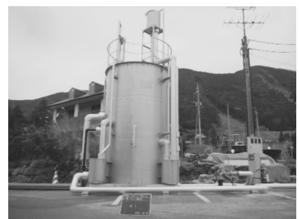
図15 設置された仮設ろ過設備
