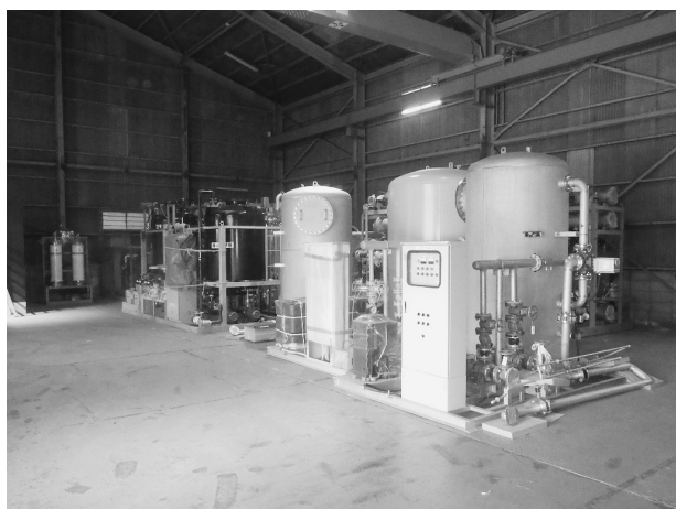
図25 備蓄している可搬式ろ過設備
