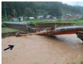
市道の落橋状況
