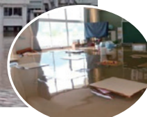
校舎の2階まで浸水
