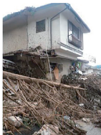
広島市の土砂災害住宅被害状況（国土技術政策総合研究所 HP）
