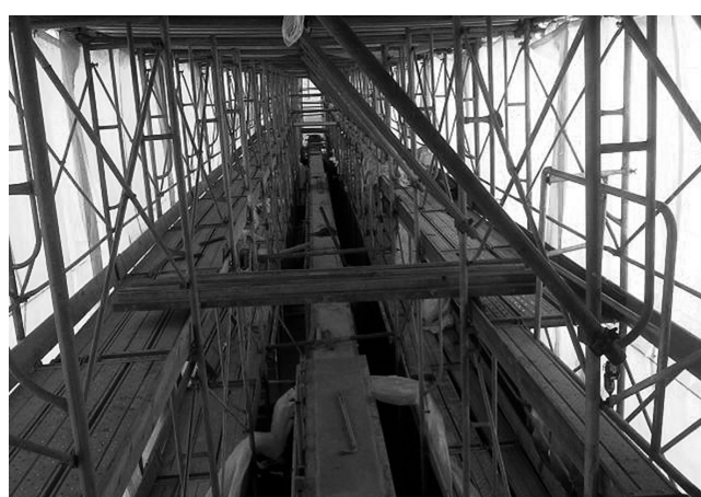
〈写真一7一4〉 宮中発電用取水ダム魚道 雪中工事の作業場の状況
