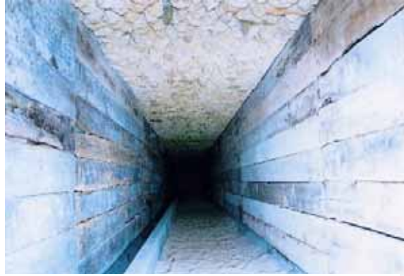
Photo 13 Substitute cave buried in spoil bank at Haneji Dam Une cave de substitution aménagée sur un talus du Barrage Haneji
