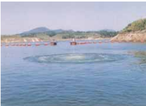
Photo 14 Intermittent aeration system Un système d'aération intermittente
