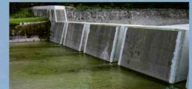
平成14年12月改修。 スリット高さ5m、スリット幅1.2m、スリット本数4本。 It was repaired in Dec., 2002. Slit height:5m, Slit width:1.2m, Slit number:4.
